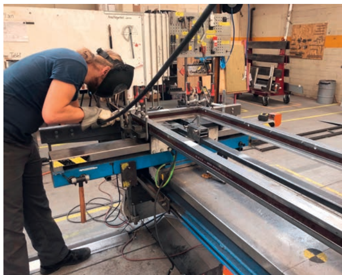
Fabian Müller bei der Arbeit an einer Rahmenschweissschleife. Fabian Müller en train de travailler sur un gabarit de soudure pour cadres.
